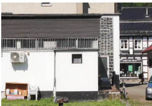
An Fassadenfarbe angepasste technische Anlage auf der Gebäuderückseite
