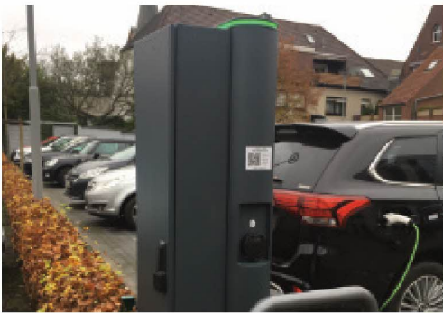
Schlicht gestaltete Ladesäule
